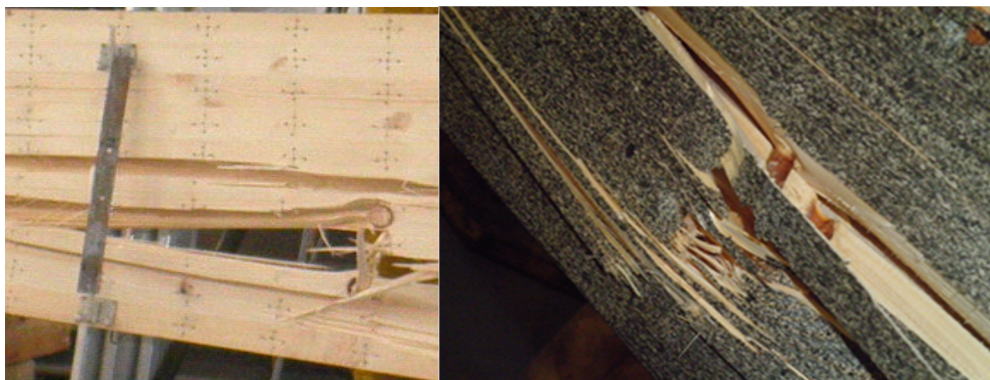
Fig. 1: A longitudinal crack
